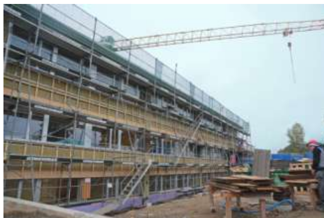
Bild rechts – energetische Sanierung: Am bestehenden Schulhaus wurden die Fassaden zusätzlich gedämmt und die Fenster erneuert.
